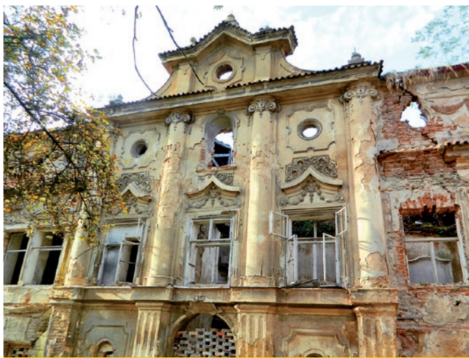
Ani se nechce věřit, že měl zámek ještě nedávno střechu.
